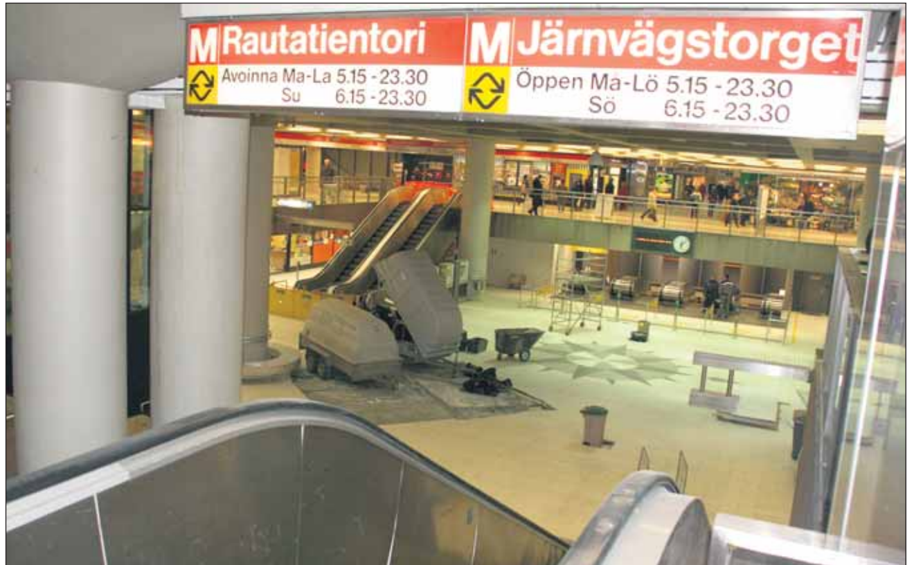
Helsingin Metron Asematunnelin suurvuoto oli pahin putkirikko, jonka Helsingin Veden Verkkoyksikön päällikkö Ari Melakari muistaa uransa aikana sattuneen.
